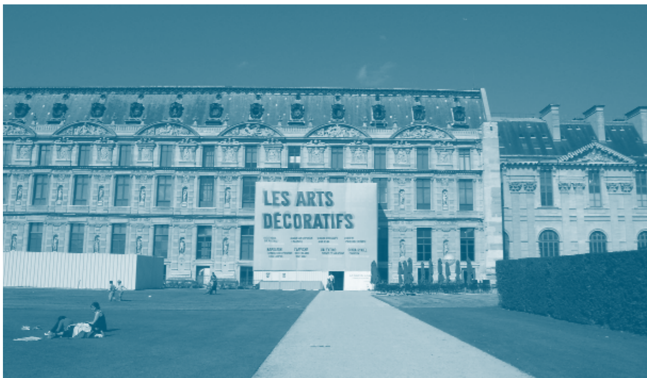
01 Bâche installée pendant les travaux de restaurations du porche d'entrée, sur la façade côté jardins du Carrousel, photo Carol Chabert
